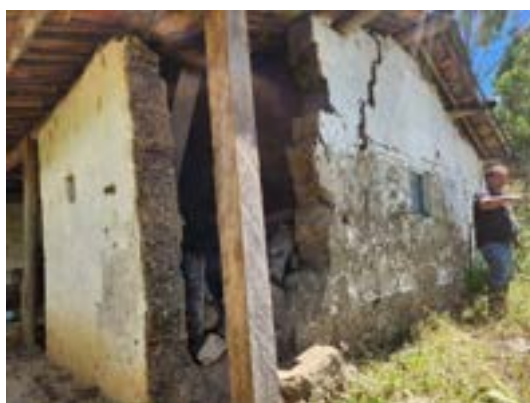
Figura 4. Vivienda afectada. Fuente: SGR, 2023
